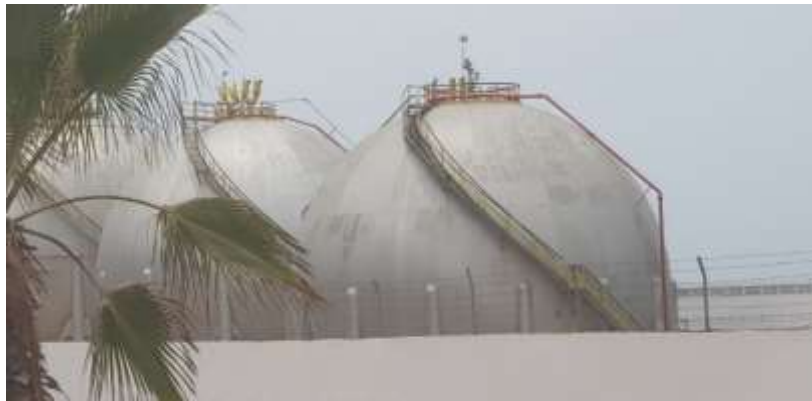
Photo 9 : Zones de stockage de combustibles des distributeurs agréés - Port d'Agadir
